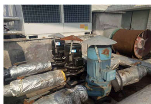
图 27: 改造后空调循环水泵
